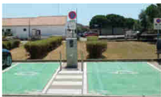
Figure 52 : Exemple de stationnement avec IRVE
